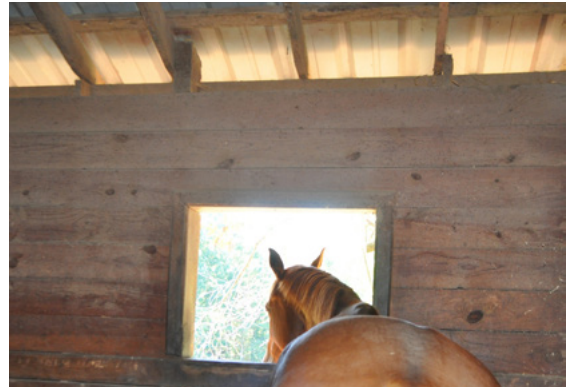
L'espace entre les parois et la toiture permet une bonne ventilation naturelle.
